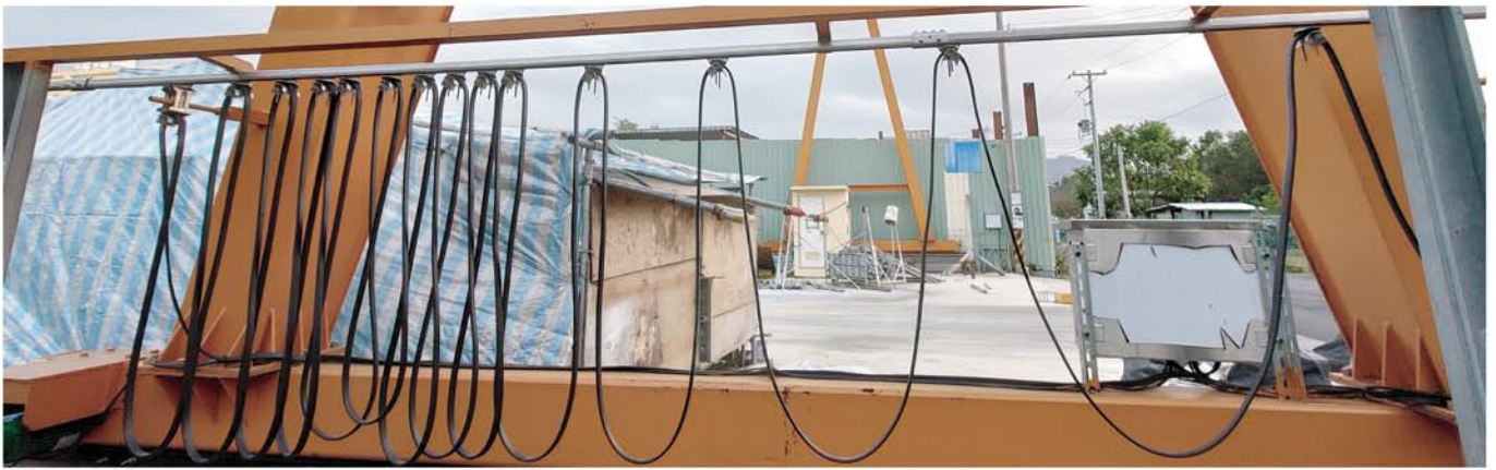
• 戶外門型吊車以白鐵C軌系統供應縱行電力
