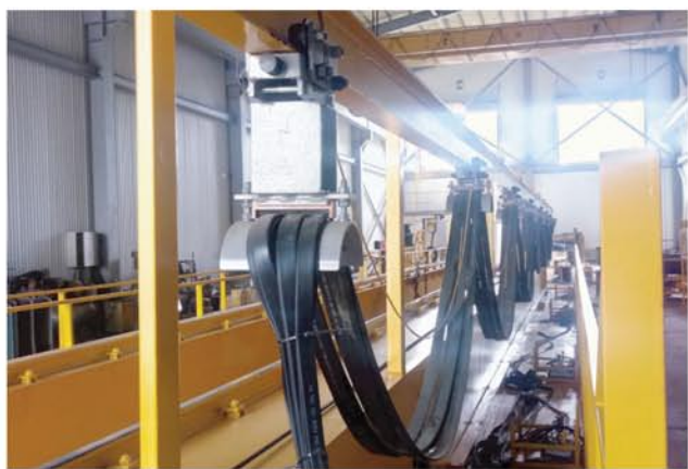
• H滑車及扁電纜配電應用
