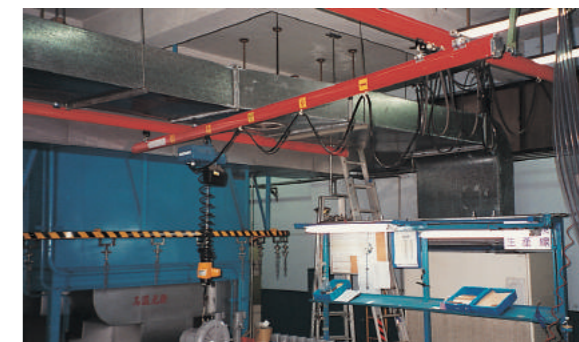
▲ 鼓風機廠生產線吊車設備
